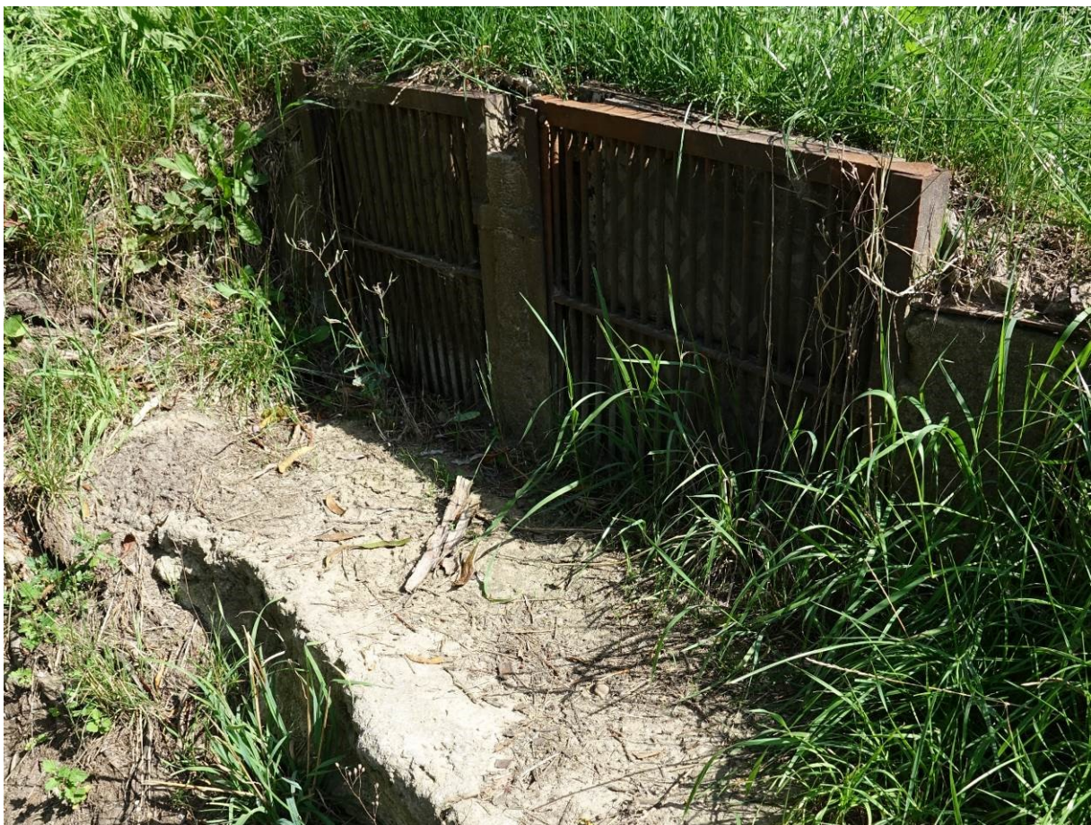
Rys. 64. Pozostałości po przelewie powierzchniowym na prawym brzegu.
