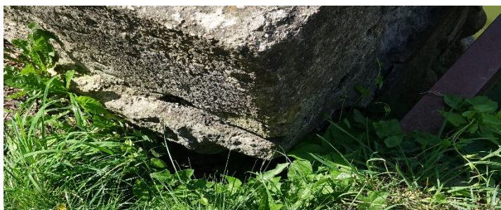
Ryc. 61. Pęknięcia i ubytki przyczółków budowli przelewowej
