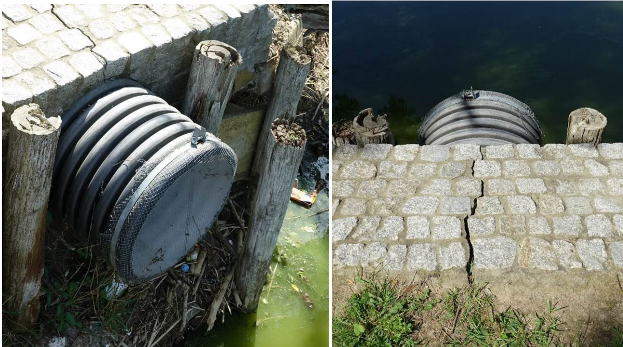
Rys. 63. Przelew powierzchniowy: przysłonięty wlot, pęknięty przyczółek.
