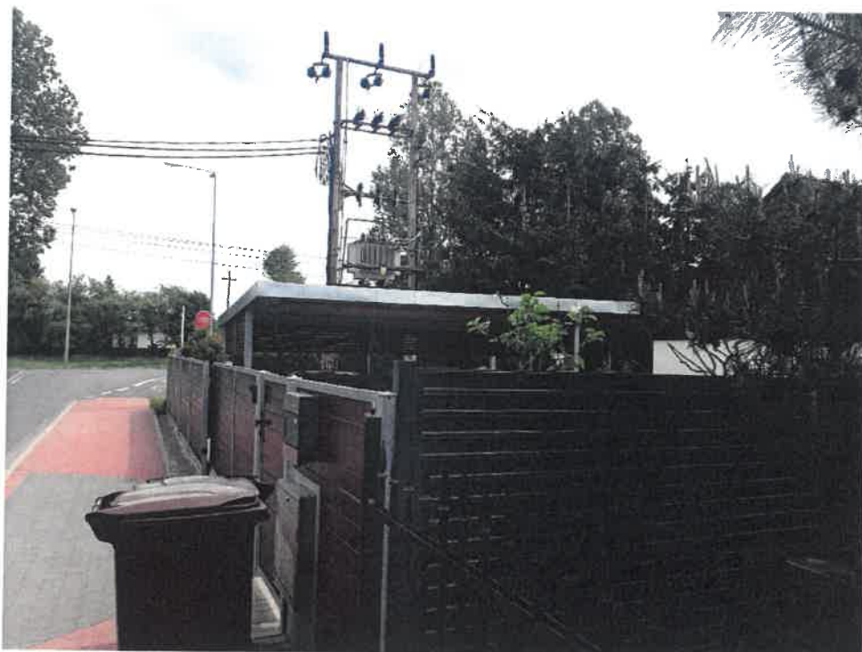
Fotografia 6 Posesja przy ul. Radosnej1B w Złotnikach na której zlokalizowano stację transformatorową słupową, od której prowadzą linie energetyczna, dalej skrzyżowanie z ul. Obornicką
