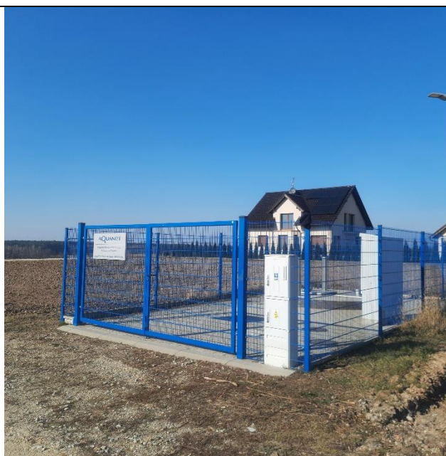
Fot. 6. Przepompownia przy ul. Akacjowej.
